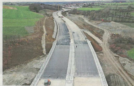
Wo Straßen gebaut werden, wird in die Natur eingegriffen. Ausgleichsmaßnahmen für Tiere und Flächen gehören zu den Pflichtaufgaben der Straßenbauer.
